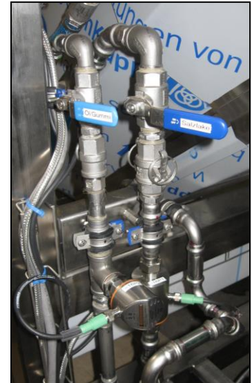
Sensoren mit Rohrleitung
